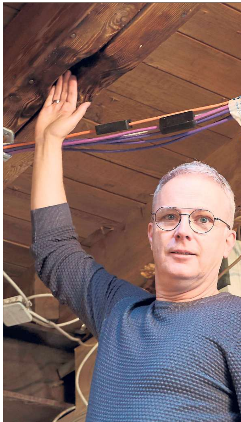
Raimund Cordes weist auf die Stelle an der Decke, wo sich der Brand in der Zwischendecke vermutlich entzündet hatte. Bilder: Schäfer
